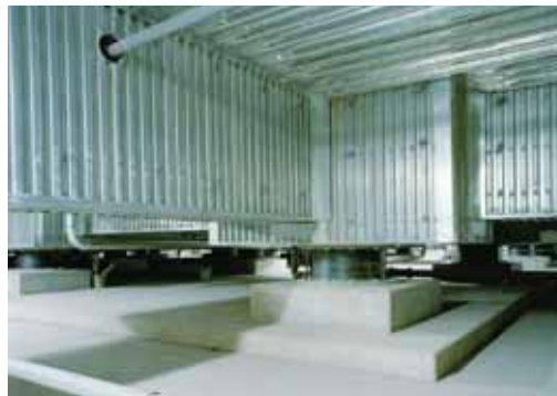
地下2階 免震ピット
